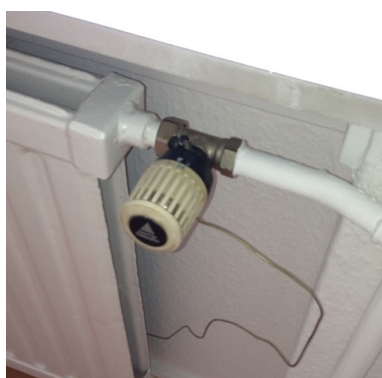
Gl. radiator og termostat
